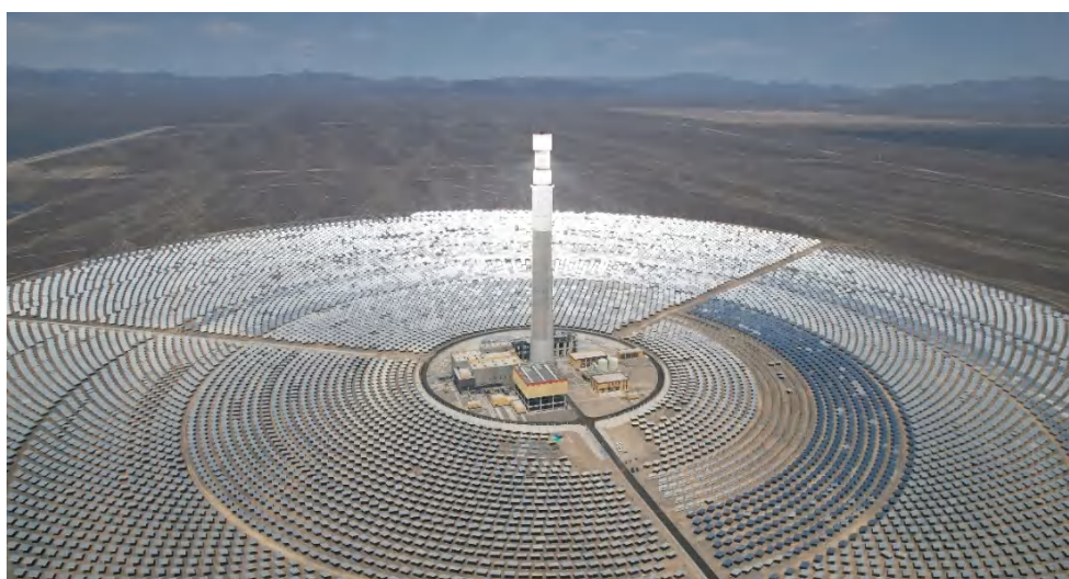
图 16-2 国家电投吐鲁番鄯善 100 兆瓦光热一体化发电项目现场
